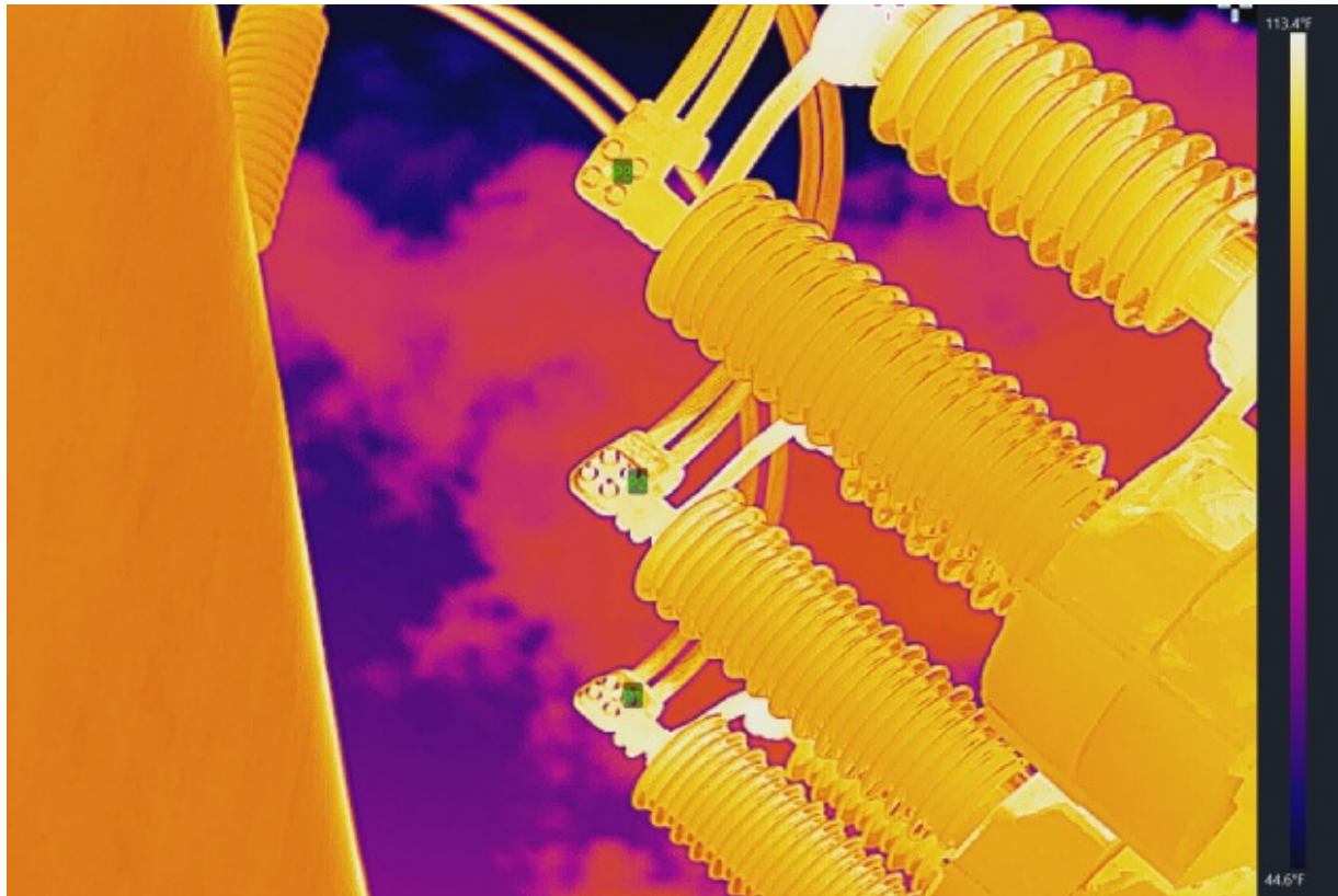
52-L1 - SF6 BREAKER
